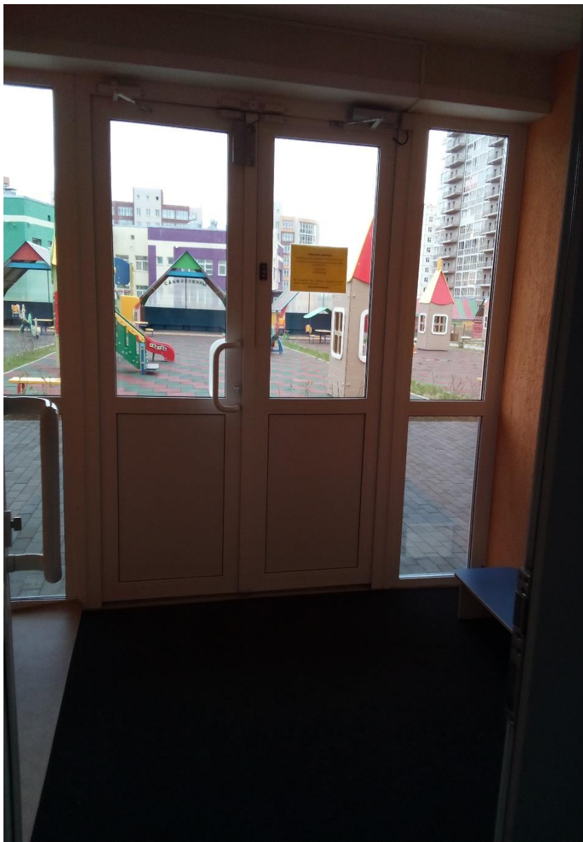
Тамбур эвакуационного выхода блок «А» № 19
